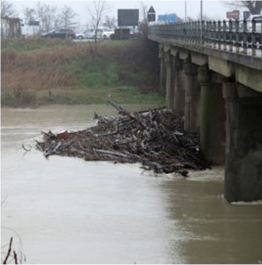
Foto 3: fiume Reno al ponte della Bastia durante la piena del 02.02.2014. Le pile del ponte intercettano materiale flottante generando turbolenze locali ed incremento della capacità erosiva del deflusso.
