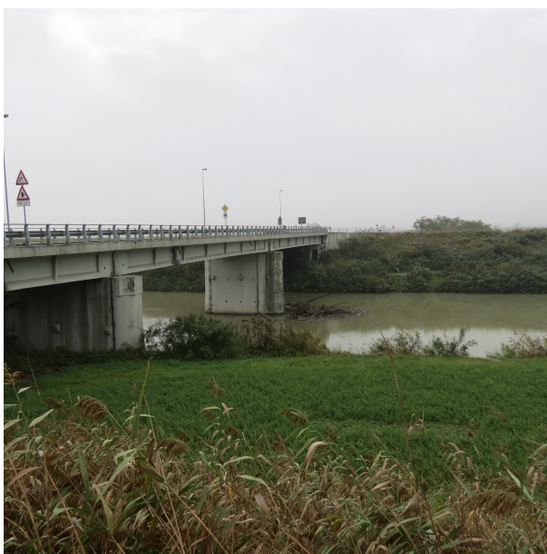
Foto 1: Ponte di via Raspona dalla sponda in orografica sinistra. In evidenza l'accumulo di materiale surnatante a monte della pila.
