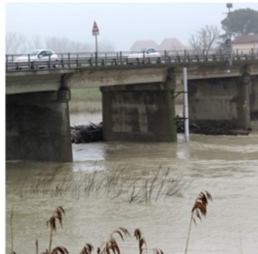
Foto 2: fiume Reno al ponte della Bastia durante la piena del 02.02.2014. Le pile del ponte intercettano materiale flottante generando turbolenze locali ed incremento della capacità erosiva del deflusso.
