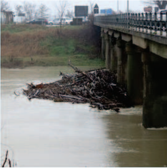
Foto 3: fiume Reno al ponte della Bastia durante la piena del 02.02.2014. Le pile del ponte intercettano materiale flottante generando turbolenze locali ed incremento della capacità erosiva del deflusso.
