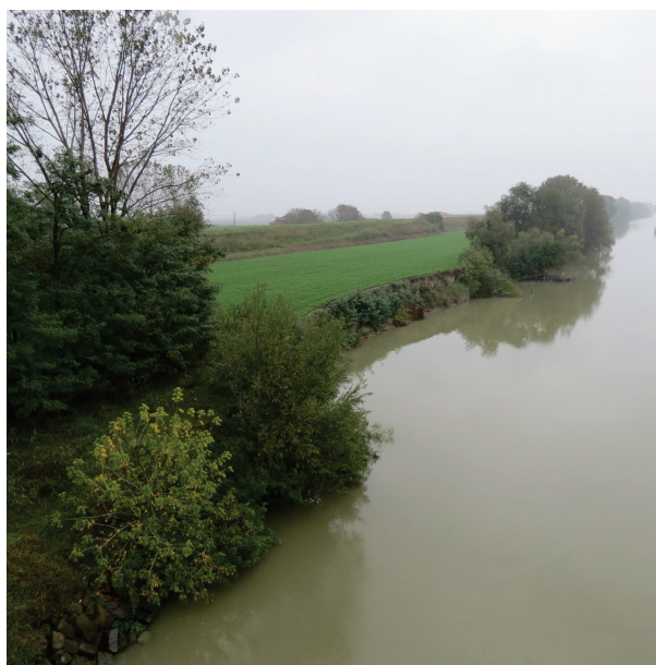
Foto 2: erosione spondale in prossimità del ponte di via raspona.
