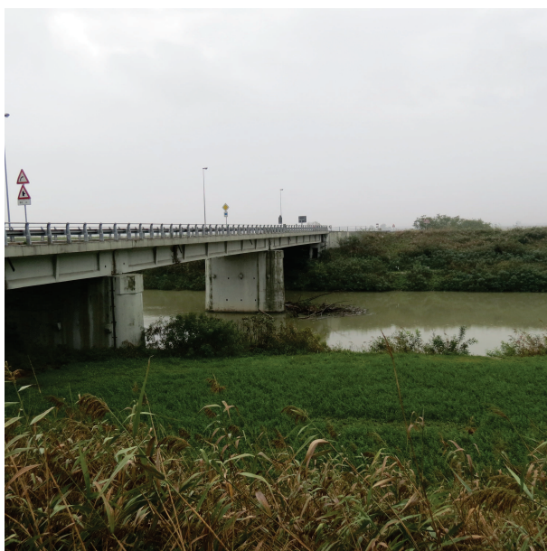
Foto 1: Ponte di via Raspona dalla sponda in orografica sinistra. In evidenza l'accumulo di materiale surnatante a monte della pila.
